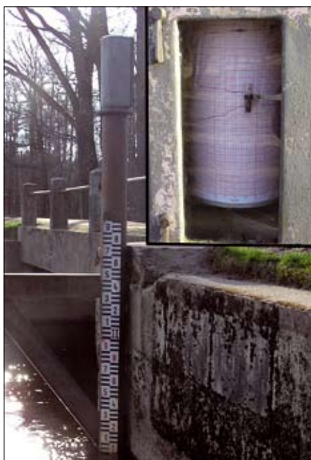
Limnigrafická stanice na Nové řece. Nad vodočetnou latí je v rouře instalován limnigraf. Vodní stavy se zapisují na limnigrafický papír (detail v pravém rohu). Foto: M. Šobr
