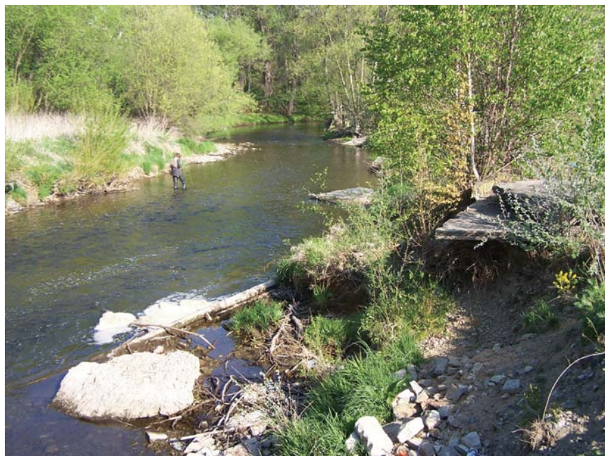
Obrázek 6: Příklad břehové nátrže nad Strakonícemi, která vznikla v roce 2002, ale je stále dobře patrná. Foto: M. Křížek, 2007.
